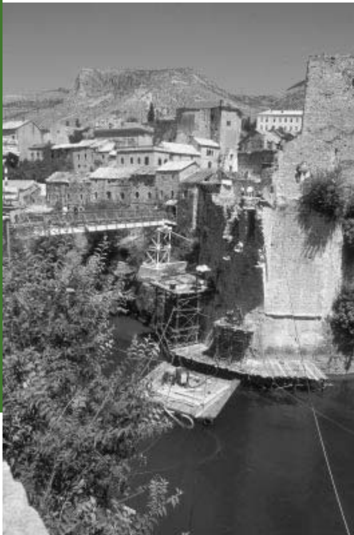
En Bosnia y Herzegovina se está reconstruyendo el antiguo puente de Mostar o "Stari Most" como parte de un proyecto piloto de conservación del patrimonio cultural, por valor de $13,5 millones. En este esfuerzo de colaboración confluyen el apoyo financiero y técnico y los conocimientos especializados del Banco y varios gobiernos y organizaciones internacionales.
